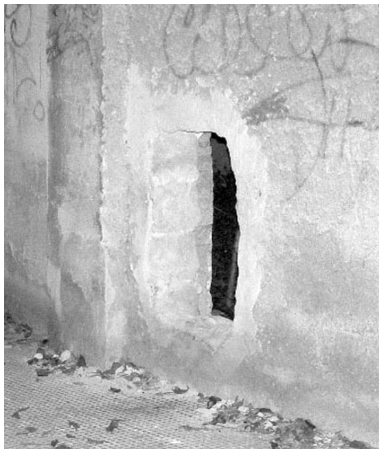
Il buco nel muro perimetrale dell'ex distilleria [foto Calvaresi]
