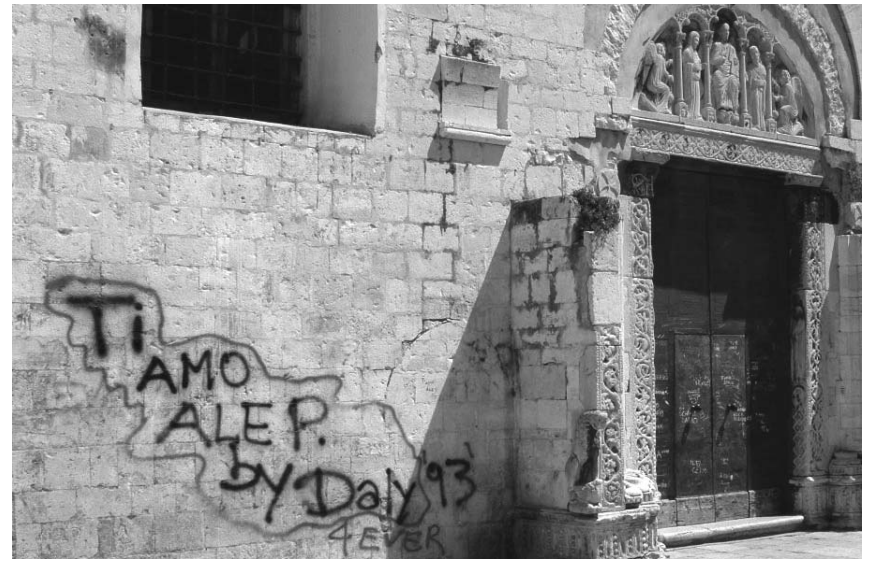
La facciata della chiesa di Sant'Andrea deturpata dai vandali [foto Calvaresi]
