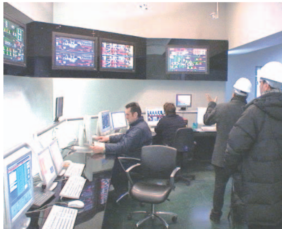
Il quadro comandi di un termovalorizzatore [foto Calvaresi]
